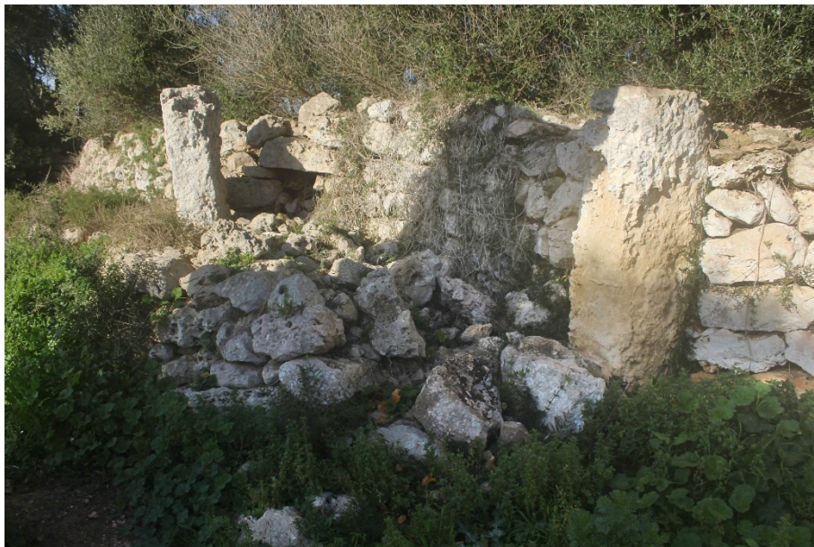
Figura 106. Restes del mur dret del recinte de taula, incorporats a una paret seca d'època històrica i afectats per la vegetació.
