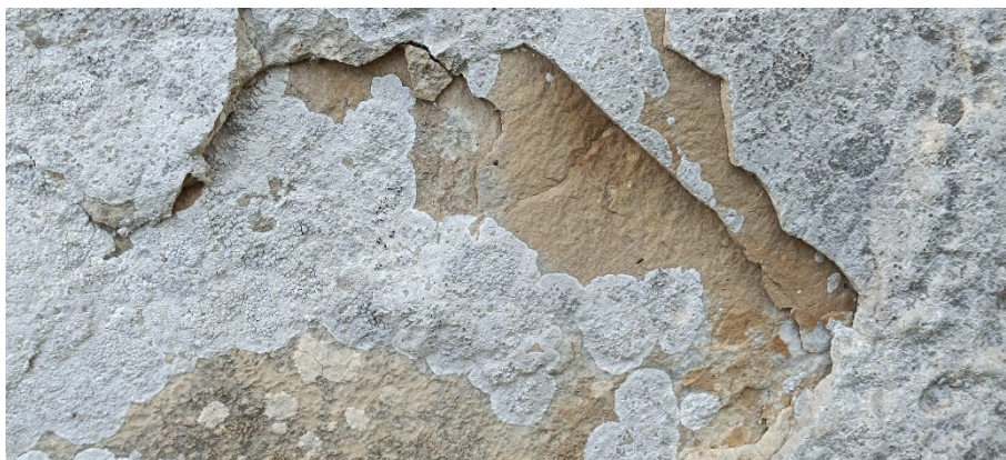
Figura 104. Exfoliació al terç inferior de la cara frontal de la pilastra de suport de la taula.
