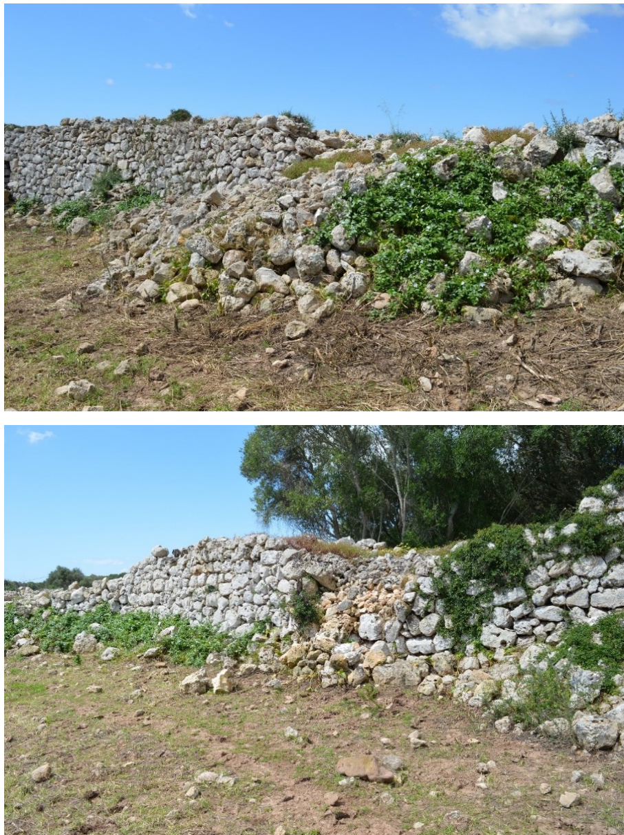
Figura 64. Punts de la muralla, per la part de l'espai visitable del jaciment, on els darrers anys s'han produït esfondraments.
