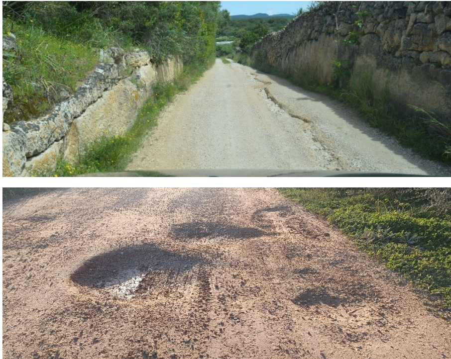
Figura 74. Xaragalls i clots al camí d'accés des de la carretera Me-1 (camí de Son Sintes).
