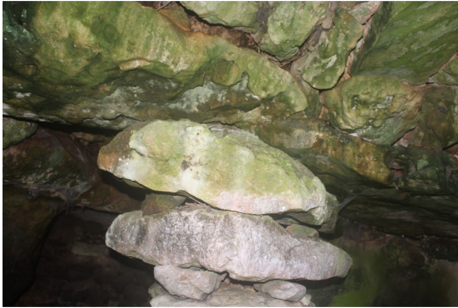
Figura 111. Sostre de l'hipogeu 3. S'observen fractures i la intrusió d'arrels.
