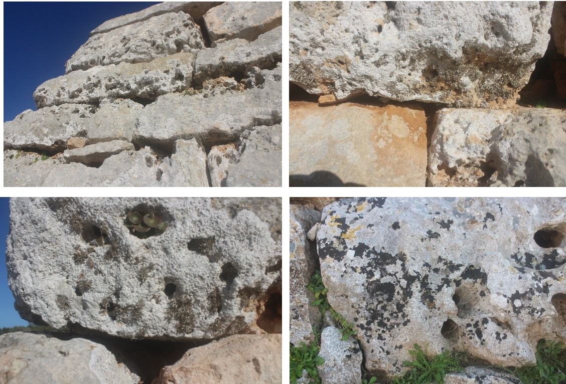
Figura 17. Detalls de la capa biològica que cobreix els blocs exteriors de la naveta.
